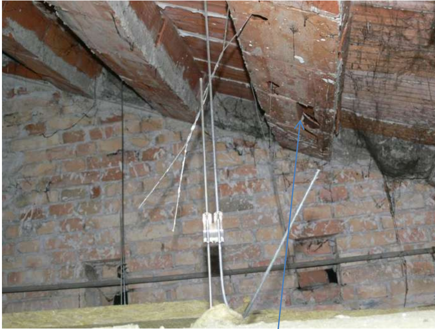
Un altro punto in cui si è manifestato dissesto statico in corrispondenza del travetto di copertura. Cedimento del fondello laterizio.
