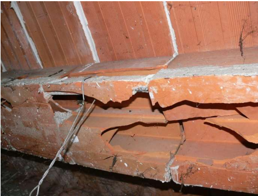
Il dissesto statico in corrispondenza del travetto di copertura. Cedimento del fondello laterizio.
