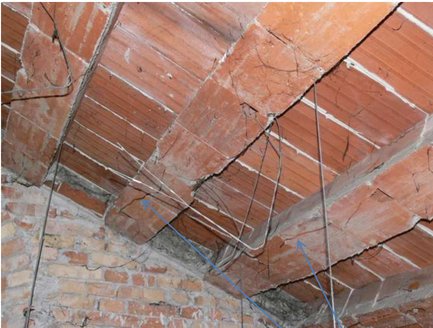
L'orditura del tetto e visibile uno dei cedimenti in atto
