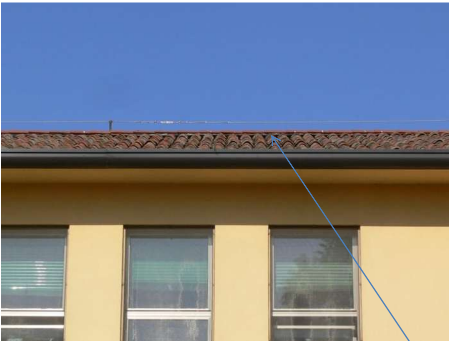
Ingrandimento sul punto in cui è visibile l'abbassamento del tetto
