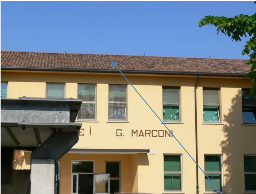
Prospetto sud: il punto in cui è visibile l'abbassamento del tetto
